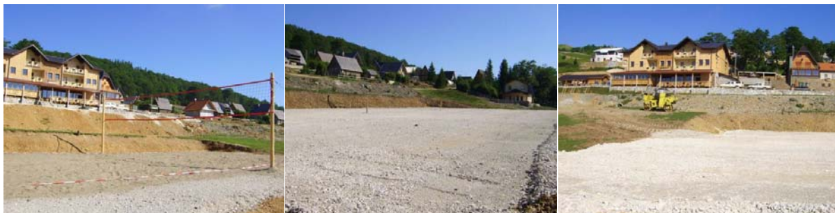
Slike 75.-77. Teren za odbojku na pijesku (lijevo); Izgradnja višenamjenskog sportskog terena (desno)
